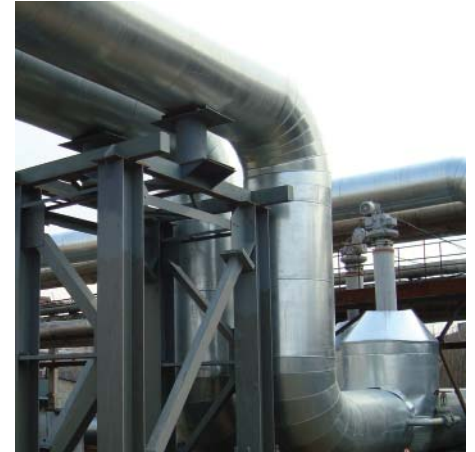
Системы вентиляции, кондиционирования и трубопроводы
